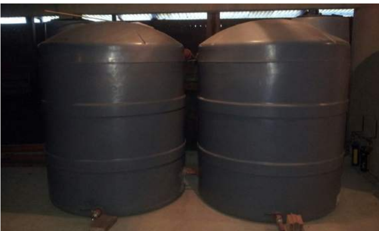
6000 lts para almacenar la lluvia que abastecerá a la instalación
