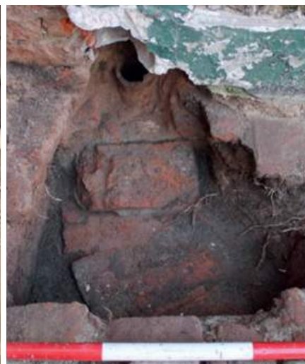
Desagüe de hierro como bajada pluvial que se conecta con los desagües horizontales de ladrillo
